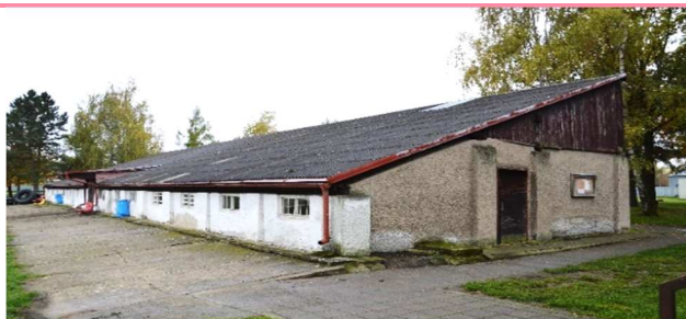
Foto objektu bývalé tribuny ploché dráhy – havarijní stav
